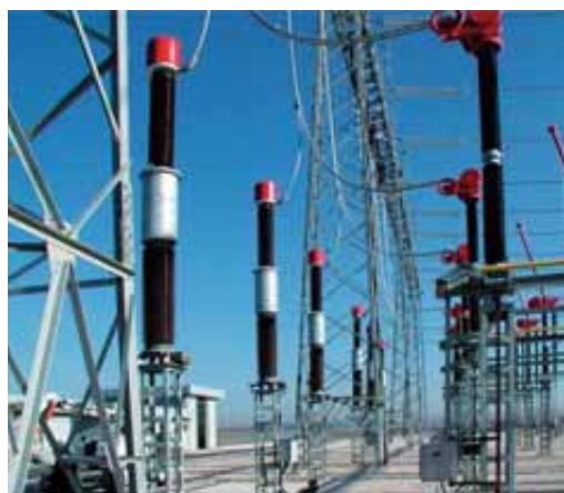
3. 420 kV Inductive voltage transformers. Rede Eléctrica Nacional (Portugal)
