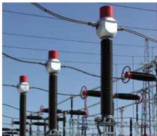
4. 420 kV Current transformers. Rede Eléctrica Nacional (Portugal).
